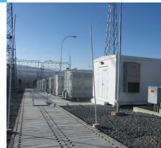
Almacenamiento de Energía con baterías
